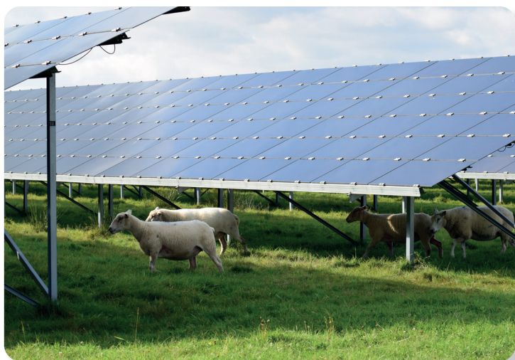
Les moutons sont protégés par les panneaux photovoltaïques
